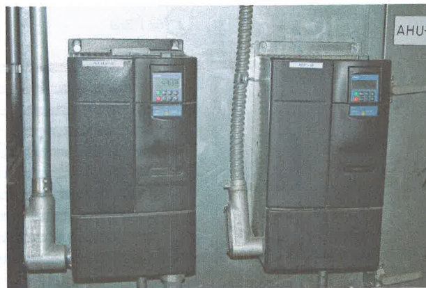
Figura 22-39 Mando o propulsor de frecuencia variable (VFD) empleado para cambiar la frecuencia del voltaje para el motor, con lo que se cambia la velocidad del motor en incrementos muy pequeños. Cortesía de la Ferris State University. Fotografía de John Tomczyk
